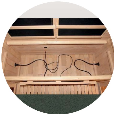
Propojení kabelů za lýtkovým topidlem
